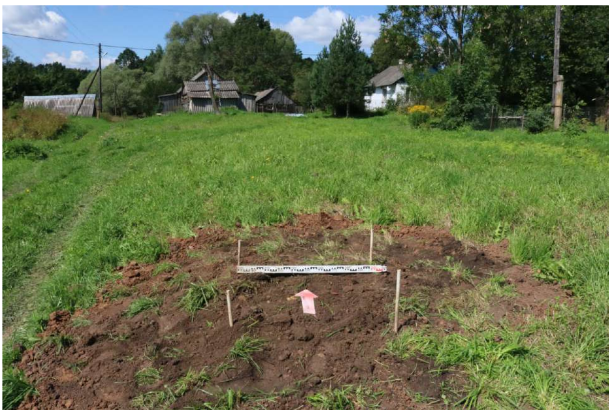
Рис. 27. Археологическое обследование участка по объекту: «Уличные газопроводы дер. Кстищи Козельского района». Калужская область. 2023 г. Шурф 2. Рекультивация. Вид с Ю.
